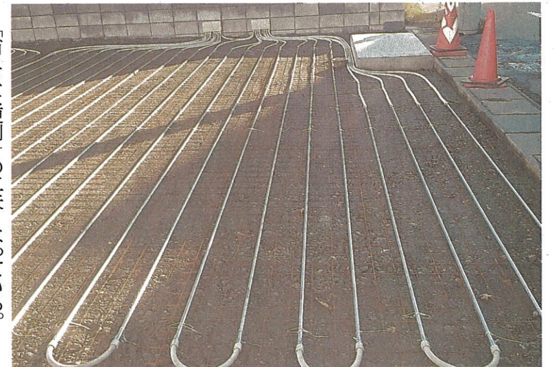
アイアールエフが開発した、ステンレスヒーターを使ったロードヒーティング。奥のケーブルを束ねる複数の四角い箱がプールボックス
